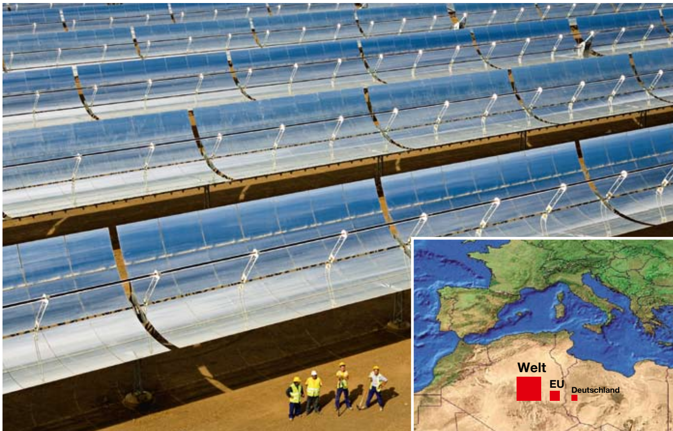
Das spanische Solarthermie-Kraftwerk Andasol 1. So soll's bald auch in der Sahara aussehen. Die Karte zeigt den Platzbedarf der Technik.
